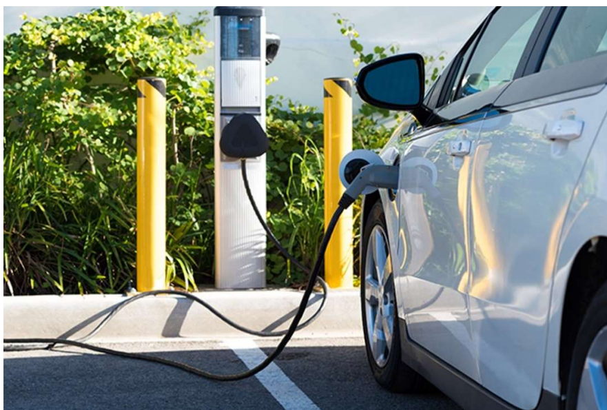
図 1：EV 充電ステーション
